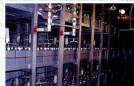
Фильтровая мощного СВ радиопередатчика
