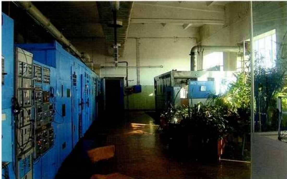
Техническое здание №2 РВС п. Тавричанка
