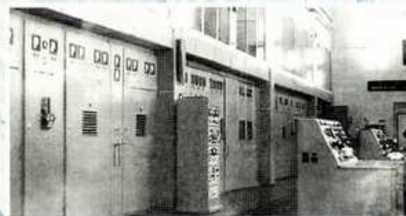
Генераторный зал технического здания № 1
